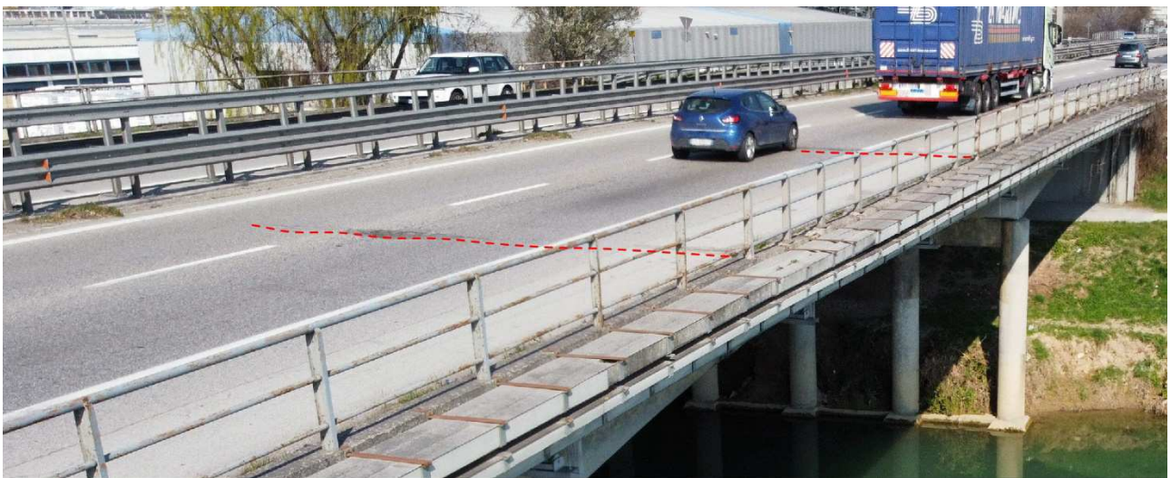
Lesioni all'estradosso del manto stradale in corrispondenza delle selle Gerber
