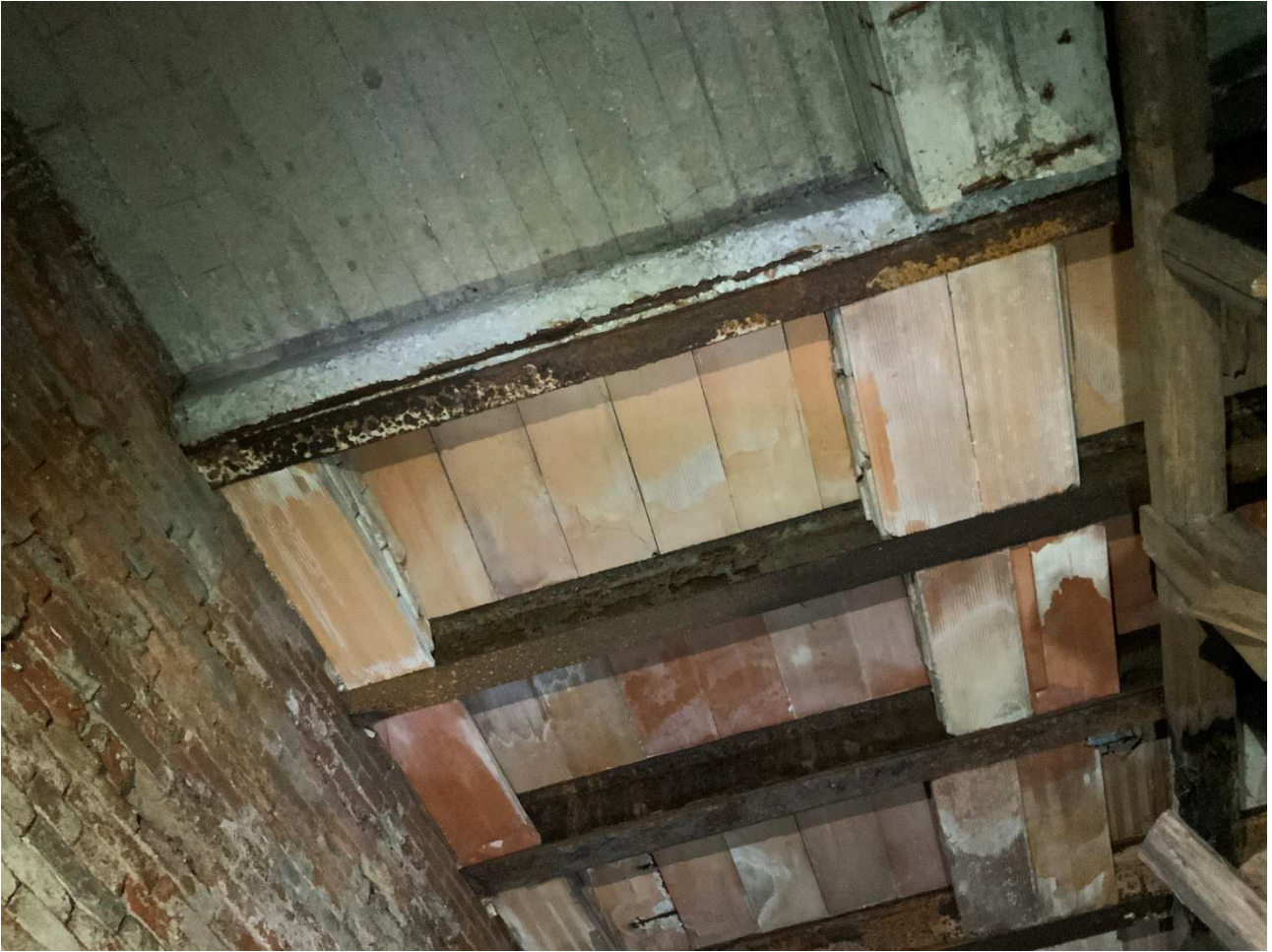
Degrado della carpenteria metallica del solaio e distacco del copriferro con esposizione dell'armatura nel cordolo e nella trave
