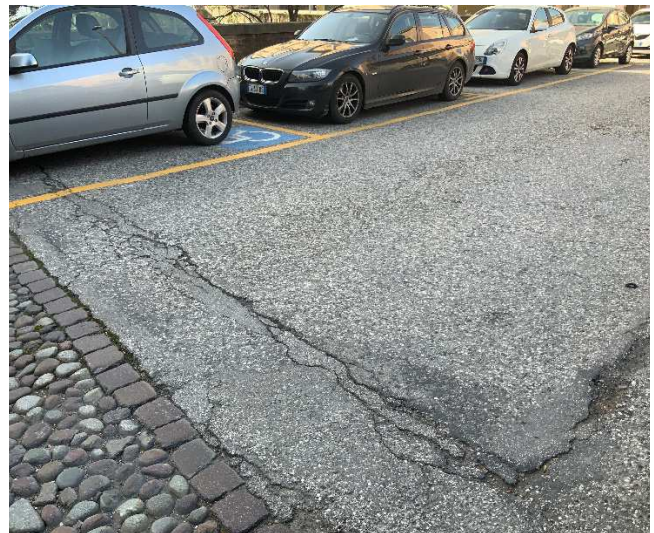
Fessurazioni della sovrastruttura stradale in corrispondenza del profilo del manufatto in c.a.
