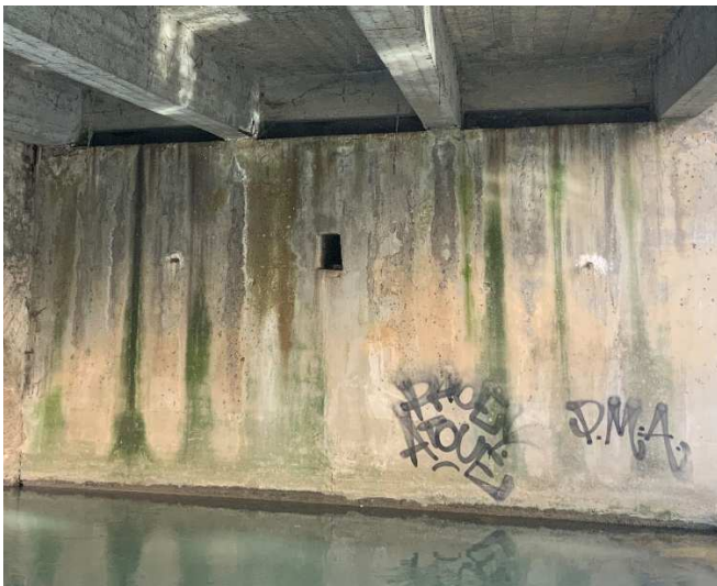
Colatura e patina biologica dovute ad infiltrazione di acqua
