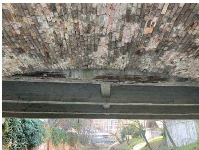
Esposizione dei ferri d'armatura corrosi nella trave adiacente alla struttura in muratura
