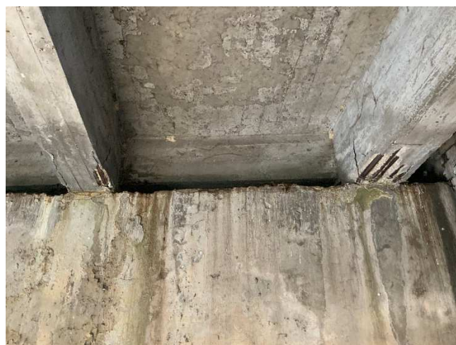
Esposizione dei ferri d'armatura corrosi negli appoggi delle travi
