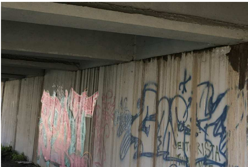
Colatura e patina biologica dovuta ad infiltrazioni nelle spalle
