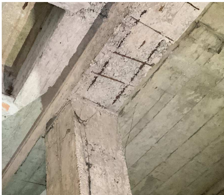
Esposizione delle armature nella trave
