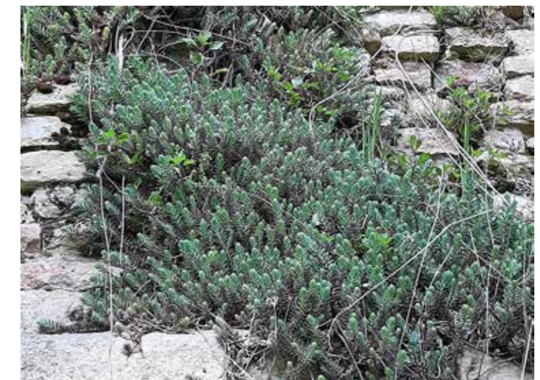
Figura 02.53. La Borracina ( Sedum spp.), una specie non invadente e non dannosa per il manufatto murario. [Giampaolo Barbariol]
