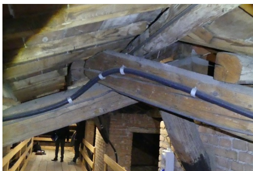
Figura 22 – Nodi di collegamento privi di carpenteria metallica
