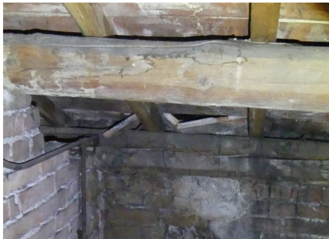
Figura 24 – Vista di alcune tavelline di copertura rotte
