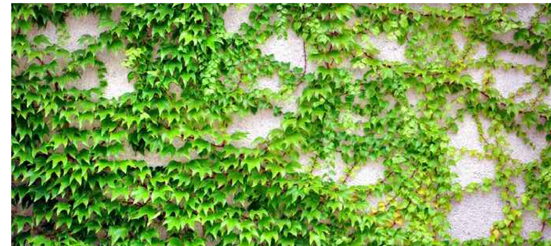
ESEMPIO DI MURO CON EDERA
